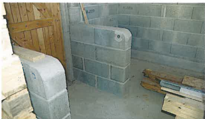
Les murs de l'abri à chevaux sont réalisés en blocs béton. Le béton de la dalle, qui remonte en plinthe de 20 cm, a une formulation spécifique, pour résister à l'acidité de l'urine animale. Deux murets avec barre en bois amovible empêchent la sortie des chevaux par la porte du garage.
