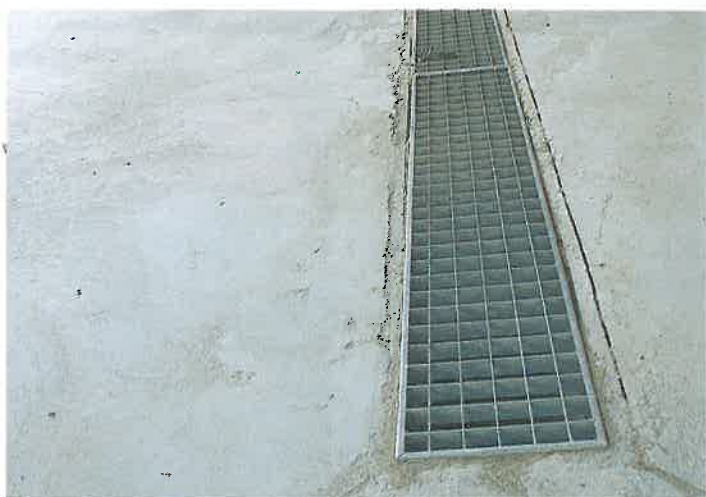
Le sol du préau de la roulotte hippomobile est une surface en béton en forme légèrement en creux vers le caniveau central d'évacuation recouvert d'une grille. Le nettoyage de la roulotte est assuré au jet par une prise d'eau alimentée par la cuve de récupération d'eau pluviale.
